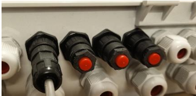
Figura 65 – Un solo dispositivo conectado, 3 enchufes
