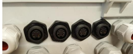
Figura 64 – 4 enchufes IP67 Modbus
